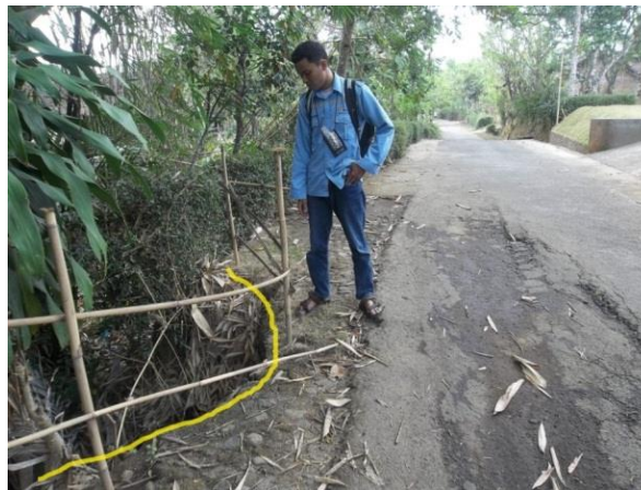
Gambar 16. Bekas longsoran di tepi jalan
