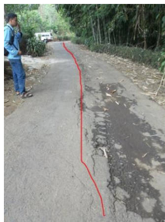
Gambar 17. Retakan di sepanjang jalan
